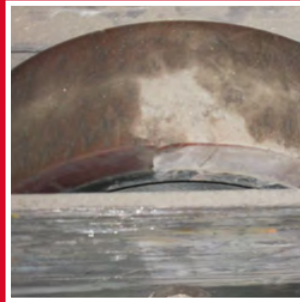
Risse oder übermäßige Abnutzung
