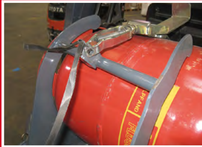
Fehlende oder beschädigte Flaschenhalterungen
