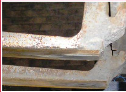
Materialabtragung an den Gabeln
